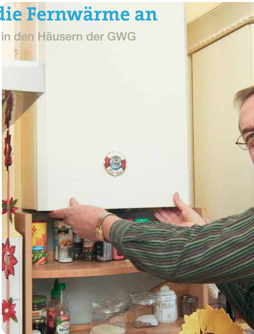
Waldemar Gebert mit der Wohnungs-Anschluss-Station an Stelle der Gastherme. Da kein Wasserspeicher m
