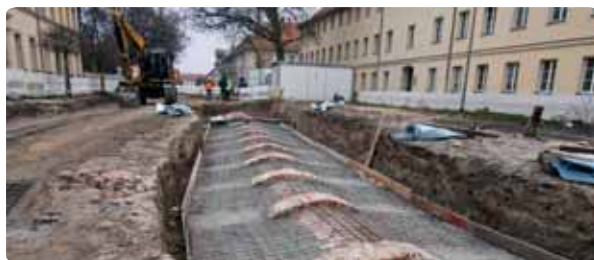
Nachher: Ein Überbau aus Stahlbeton - hier das Flechtwerk aus Armierungsstahl - stabilisiert das Gewölbe.
