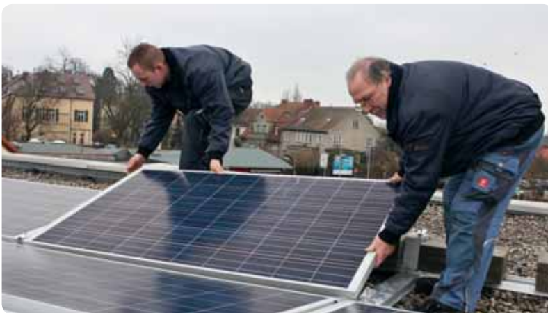
Patrick Paesker und Roland Rabsch von der Firma Runge installieren die Photovoltaikanlage.
