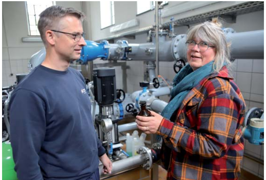
Dirk Zimmermann mit Yvonne Houben bei der Entnahme von Wasserproben fürs Labor. Kleines Foto: Beim Messen der Pegelstände im Trinkwasserbrunnen zusammen mit Roland Schröder.
