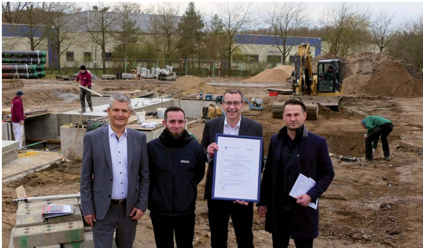
Die Stadtwerke präsentieren stolz ihre Bergbau-Erlaubnis für die Erdwärmegewinnung: Kaufmännischer Leiter Guido Gerlach (links), Ludwig Zab, Leiter Energieversorgung, Geschäftsführer Thoralf Uebach und der Technische Leiter Artur Dzasokhov.
